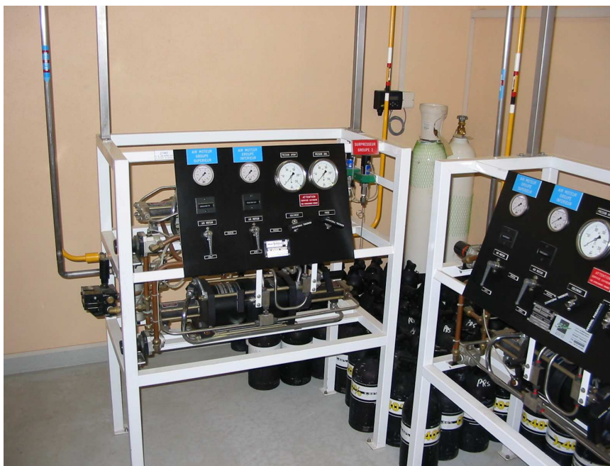
Slika 10: Visokotlačna pretočna črpalka (super charger) s kontrolno ploščo (2x) in pnevmatskim pogonom
