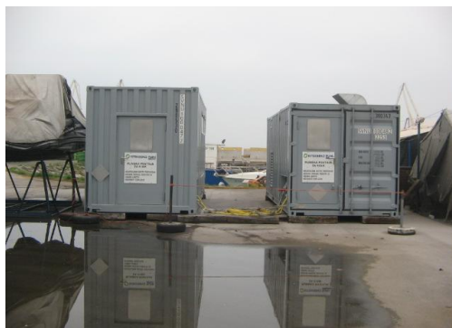
Slika 31: Zabojnika, med seboj povezana z el. kabli, visokotlačnimi cevmi, cevmi za pretok hladilnega oziroma ogrevalnega medija.
