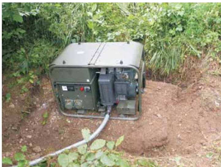
Slika 7: Elektroagregat, postavljen na ustrezno urejenem mestu.
