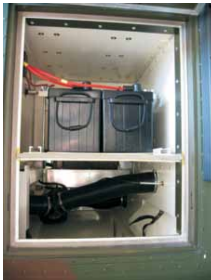
Slika 17: Prostor za pritrditev sistemskih baterij.
