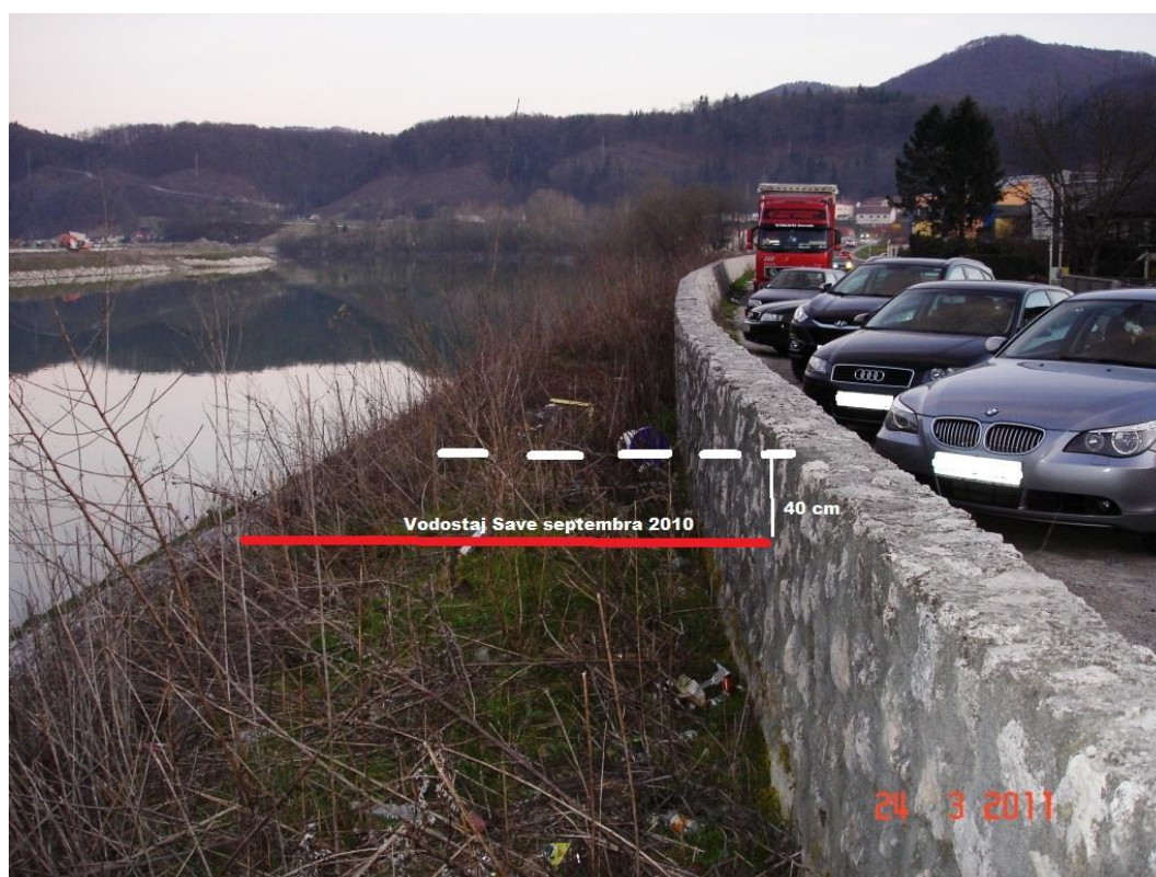
Slika 6: Protipoplavni zid v Dolenjem Boštanju v občini Sevnica
